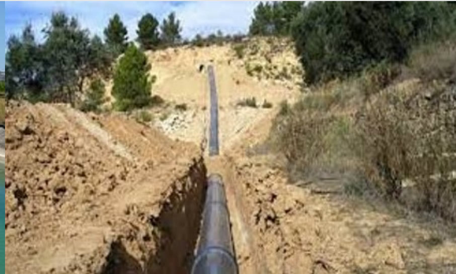
Régimen en presión: Tuberías Ambroz
